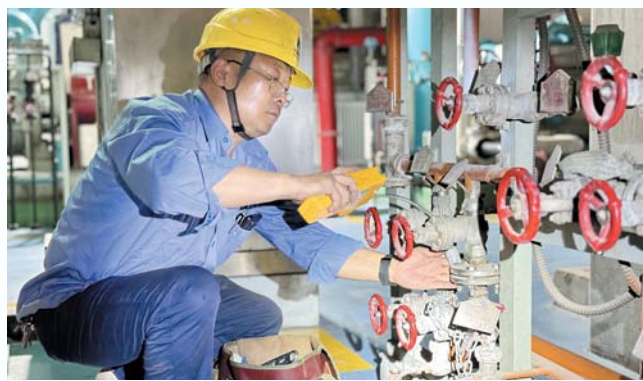
黄台电厂运行人员正在测氢。
