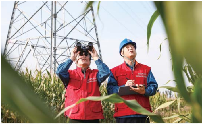
供电员工正在对所辖220千伏陵万线开展国庆节前的特巡特护。 徐娜 摄
