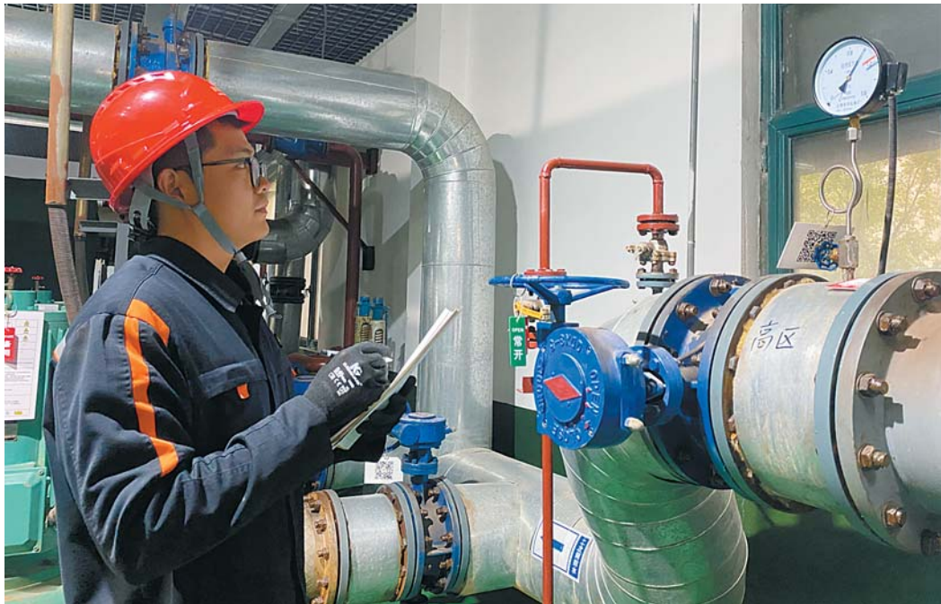
供暖管家黄祯正在换热站进行巡检。
