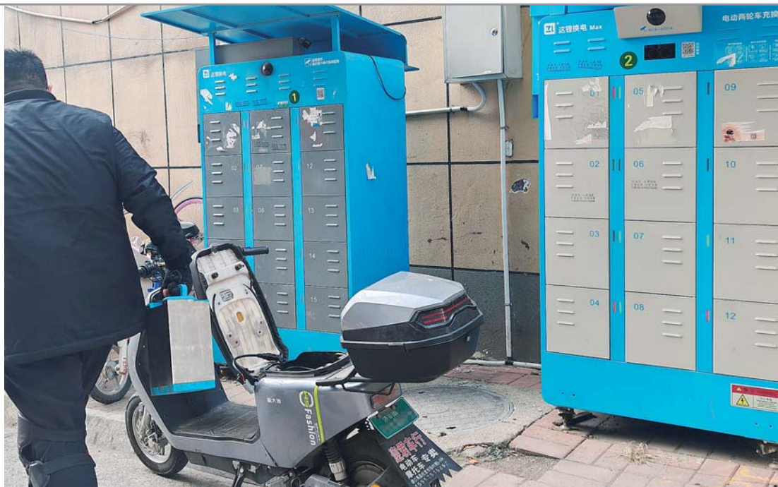
济南一小区门口的换电柜前，一位市民正准备为电动自行车更换电池。
