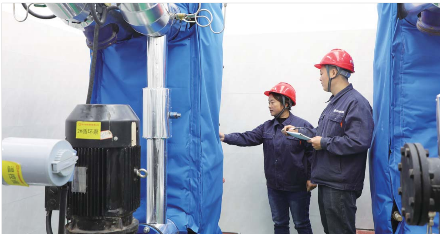
四和供热有限公司工作人员正在排查设备。
