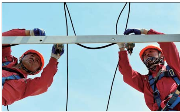
渤海供电管理区对6千伏高压线路停电检修。 通讯员 陈萍 摄
