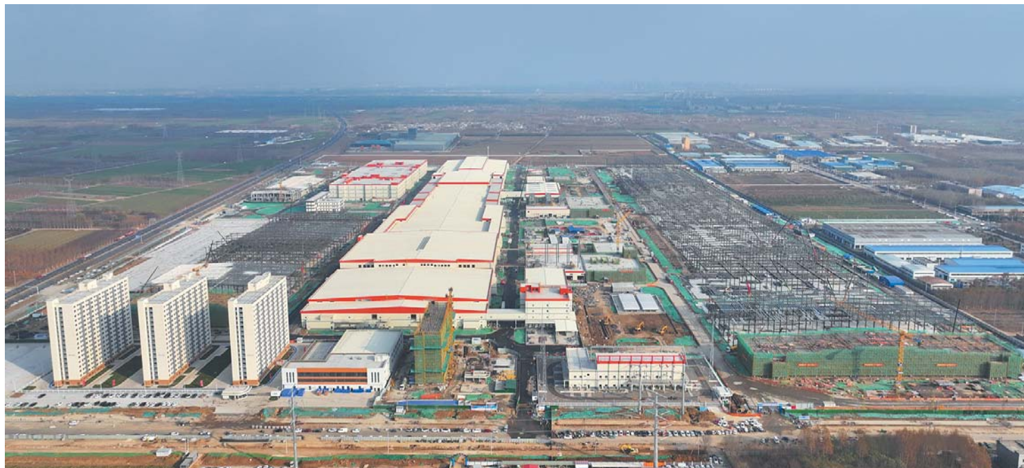
位于济宁兖州区的山东时代新能源电池基地项目一期厂房主体建设已完工，配套设备正进场安装。受访者供图
