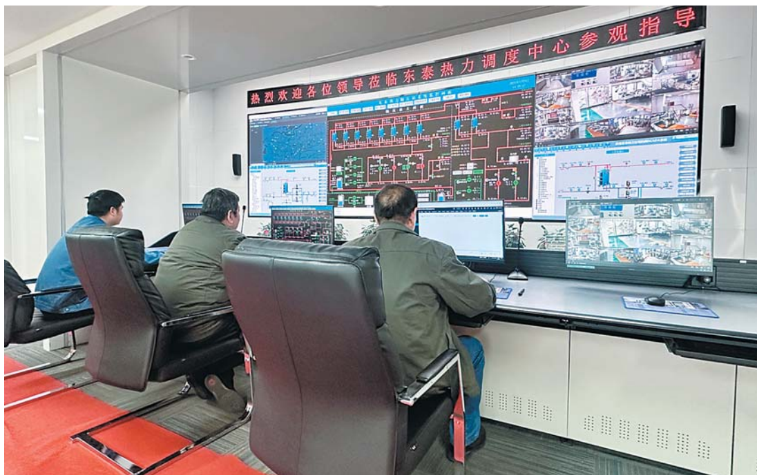
调度中心内，工作人员密切监测设备运行情况。
