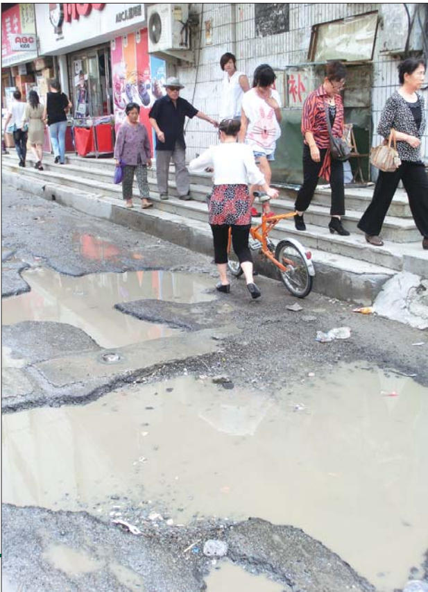
坑洼处存满积水的路面。 本报记者 段学虎 摄
