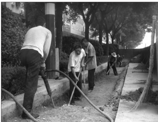
在南胡南社区积水点,养护人员正忙着开挖一条埋设管道的方沟。
