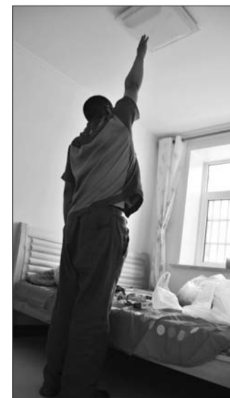
▲经过测量,天花板下塌部位距地面的高度,较正常房高低了5公分左右。
