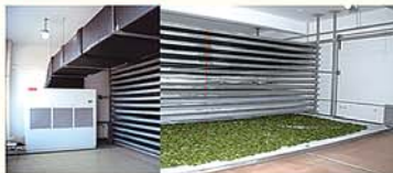
恒温恒湿空调及萎凋架
