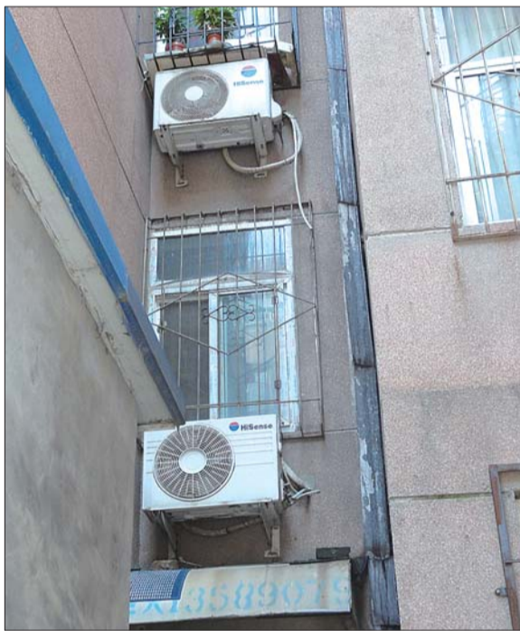
在一老小区,很多空调水直接滴到了遮雨篷上。
