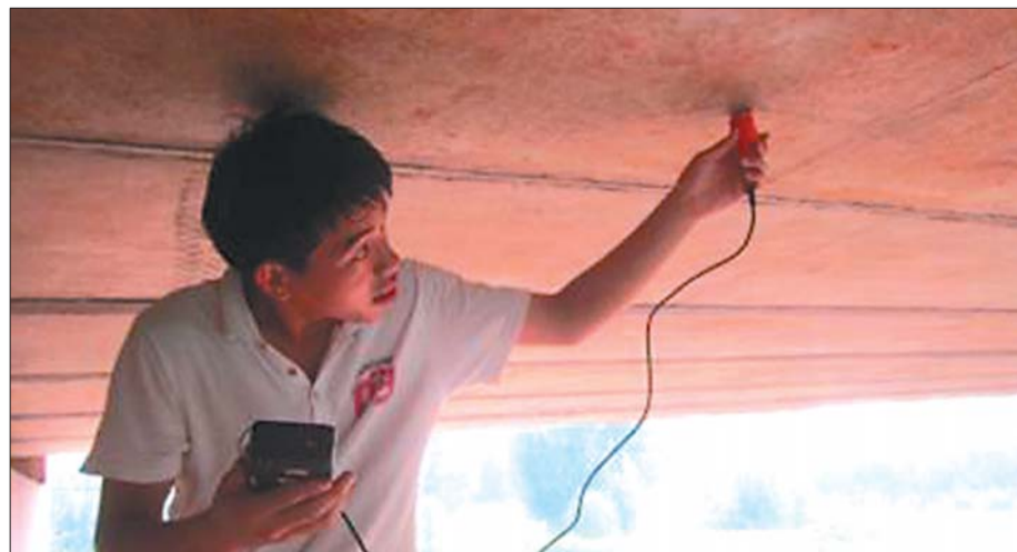
长清交通运输局工作人员正在对辖区桥梁进行检测检查。
