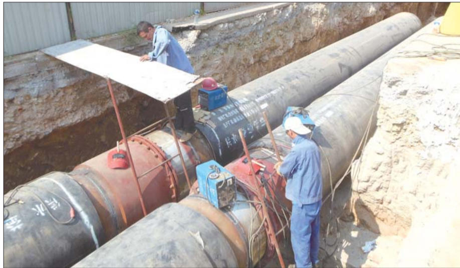
工业南路输暖管网改造,工人正在对管道进行铺设和焊接。
