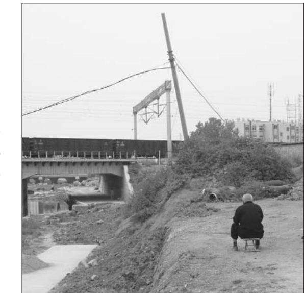
施工现场歪斜的电话线杆。 本报见习记者 韩微 摄
