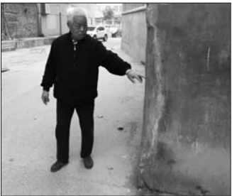
小区消防通道处的拐角,多次碰撞后墙面已出现破损。 本报记者 王欣 摄
