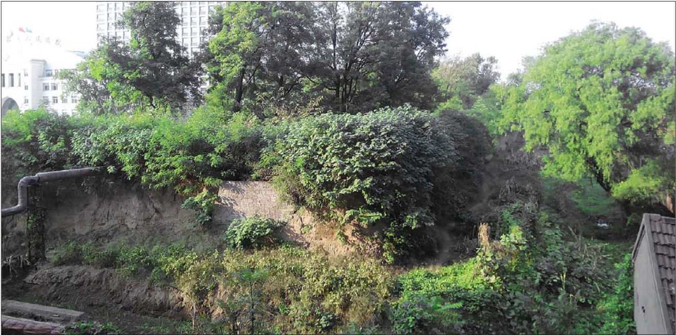
土圩墙南侧外墙被树木遮蔽，部分已出现坍塌。
