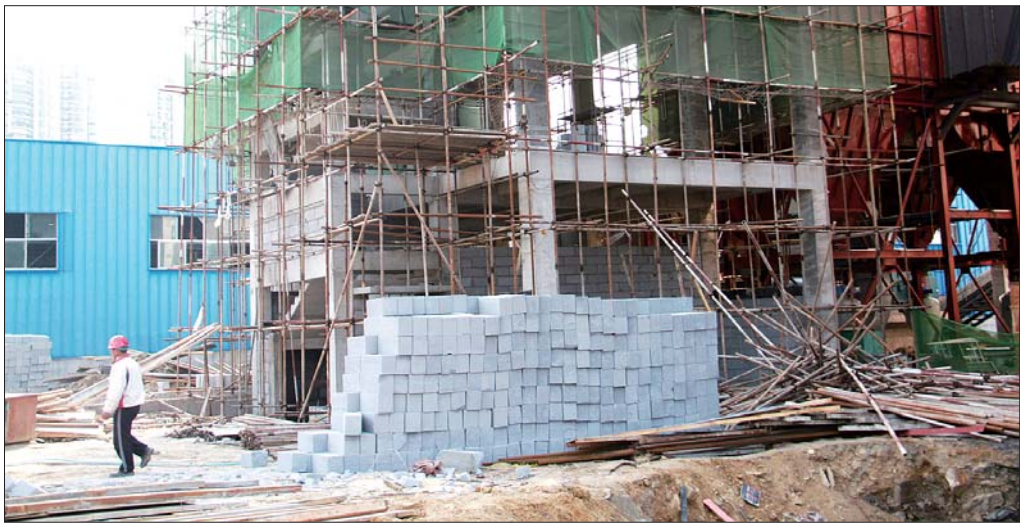
山海天热力公司供热设备升级改造预计 22 日可完工,25 日开始供暖。 本报记者 刘涛 摄
