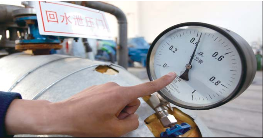
近几天降温,淄博双星供热杜科站循环泵正在全力运行。 本报记者 王鑫 摄
