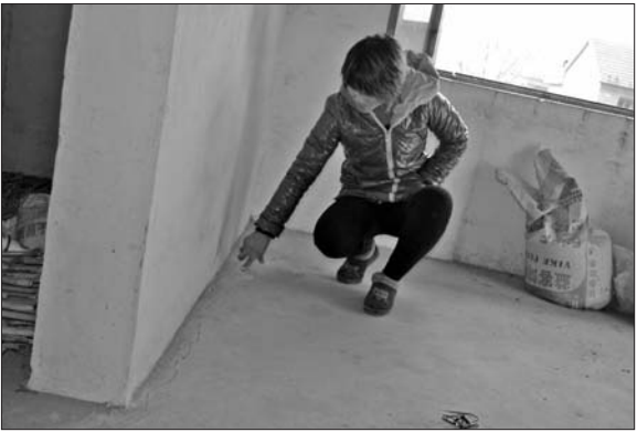
山口村一户居民家的地面出现裂痕。本报记者 王伟强 摄
