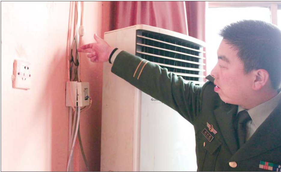
墙壁上的电源线裸露在外面。本报记者 岳茵茵 摄
