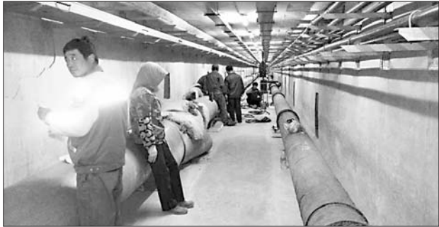
有了地下管廊，“马路拉链”在青岛高新区绝迹。本报记者 高扩 摄
