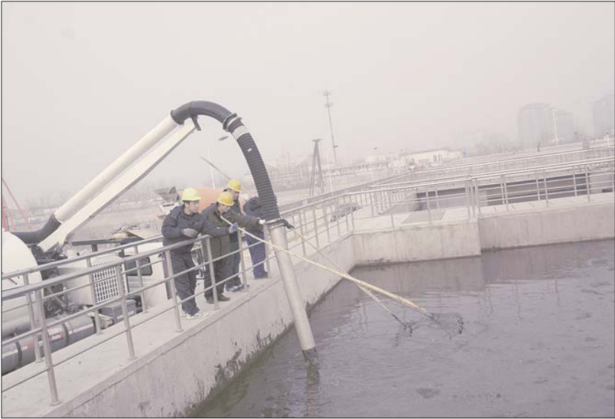
套子湾污水处理厂的工作人员正在生物池旁边打捞残渣。 本报记者 张晶 摄
