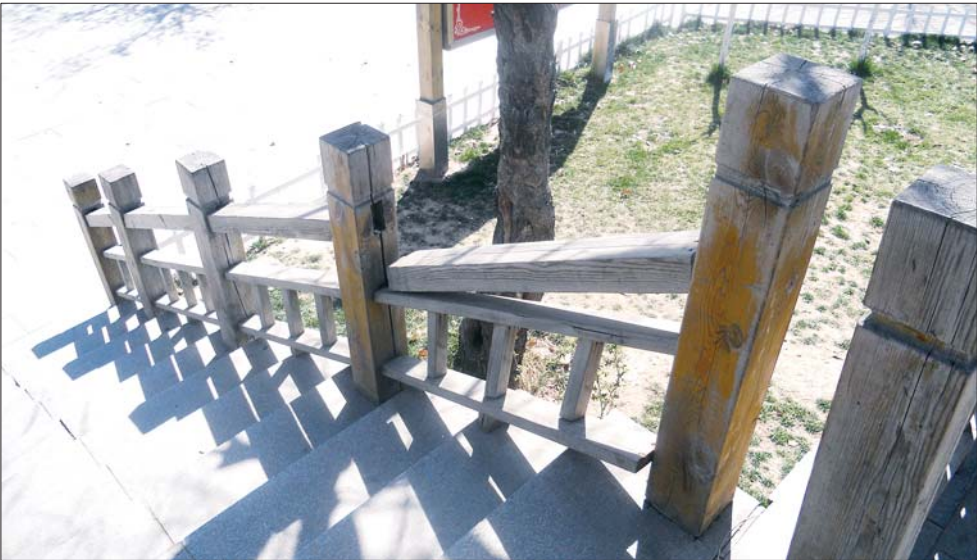
公园一处亭子边,木质护栏的一段已经脱落。 孟杰 摄
