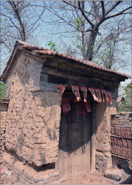
▲村中一座门楼已被侵蚀的很厉害。
