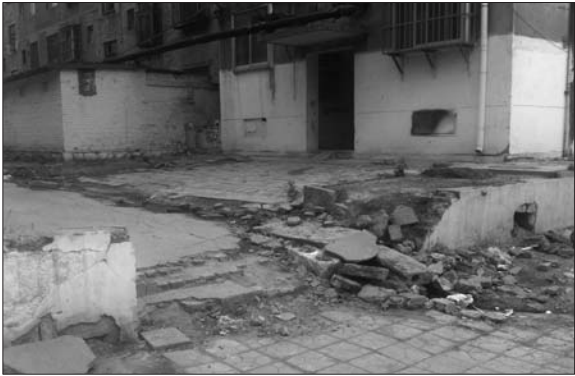
淄川区松岭东路南生活区15号楼门前污水流了一片。 本报记者 罗旭君 摄
