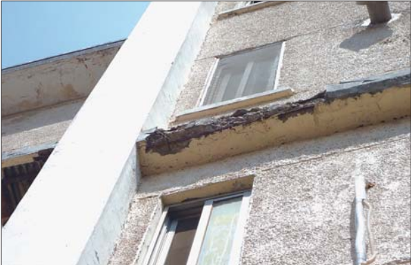
14日早晨,此处墙体的水泥块脱落。 本报记者 于飞 摄
