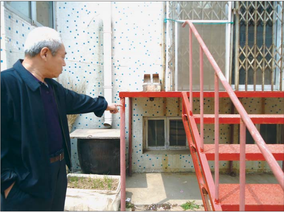
孙先生说,有楼梯挡在前面,地下室里透不进光。 本报记者 于飞 摄
