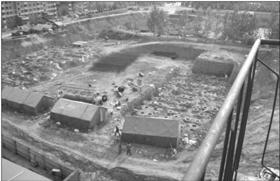
施工工地离3号楼最近距离不到30米,村民认为工地爆破是导致房子开裂的原因。 本报记者 柳斌 摄
