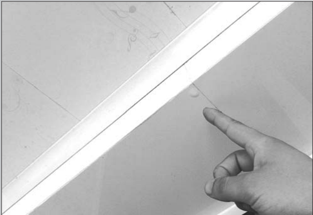
赵先生家中的厨房雨后漏水。 本报记者 尹海涛 摄
