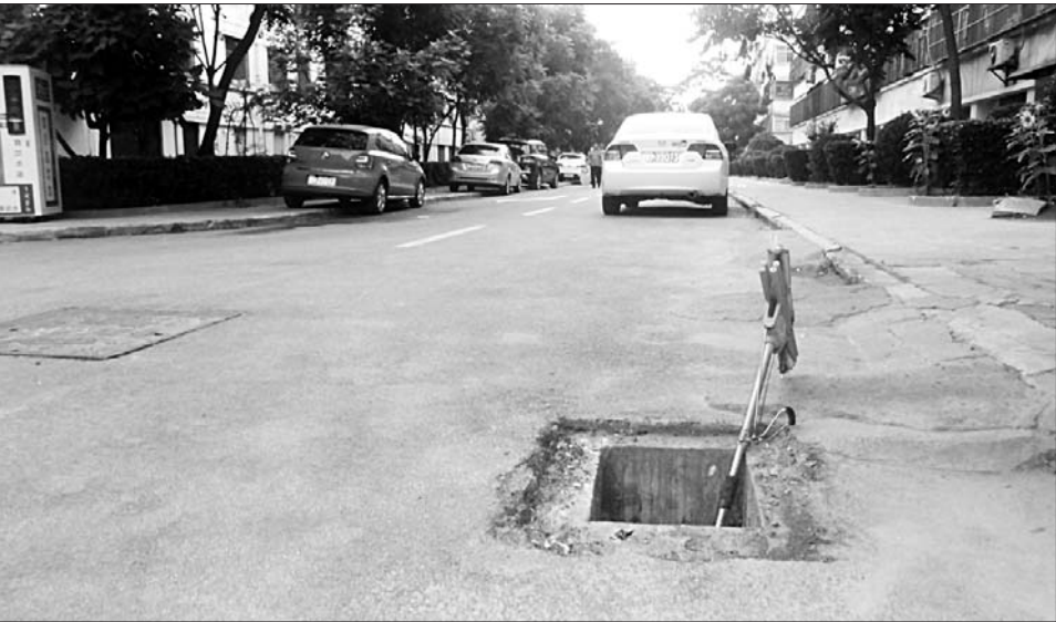
为防止安全事故，有市民在丢失下水道井盖的井口做了标记。本报见习记者 苏洪印 摄
