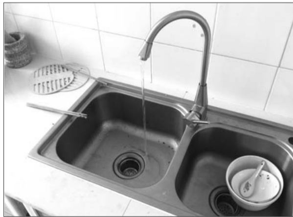
在牟先生5楼的新房中,因为水压太低,厨房的水龙头冒出一条细水柱。
