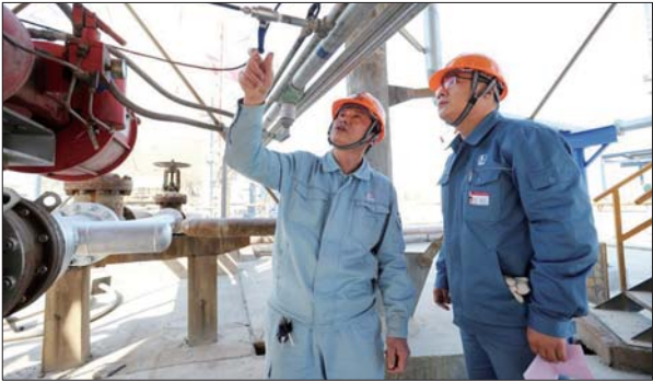
齐鲁石化工作人员检查设备(资料片)。 本报通讯员 苏峰 摄
