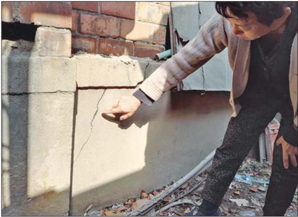
楼房外面的裂缝有一米长。 本报记者 任磊磊 摄
