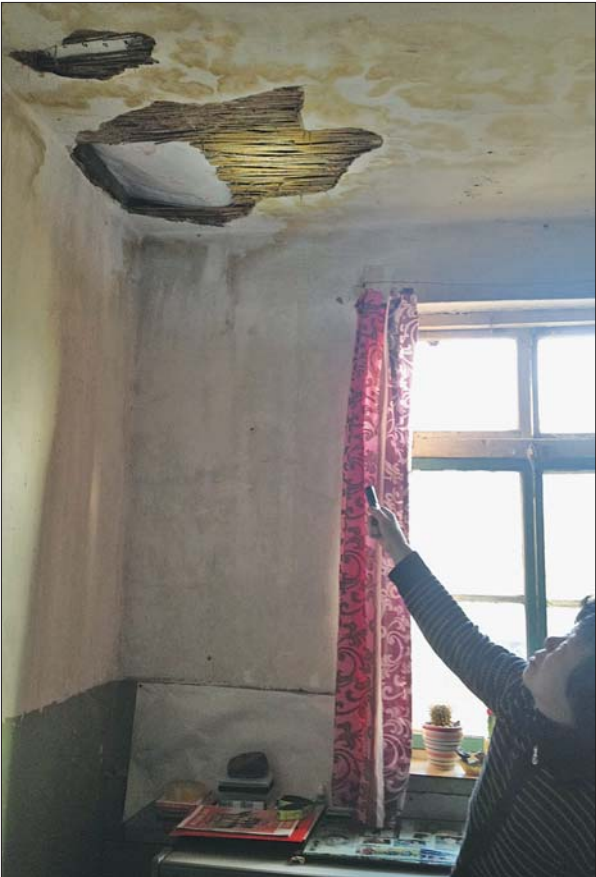
天花板上到处是破洞,只能用纸勉强糊上。
