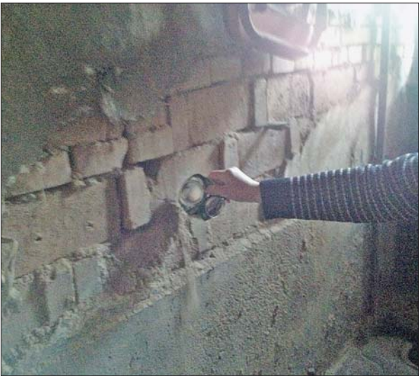
厕所墙壁的墙皮已经脱落,用铁片一刮哗哗往下掉黄土。
