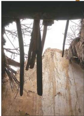
东屋房顶也已坍塌。
