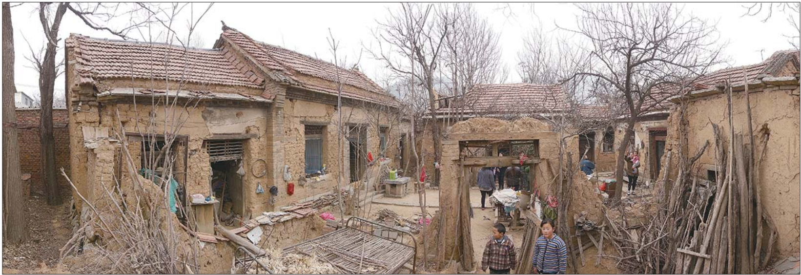
老院全景。典型的北方四合院，西屋已经坍塌。
