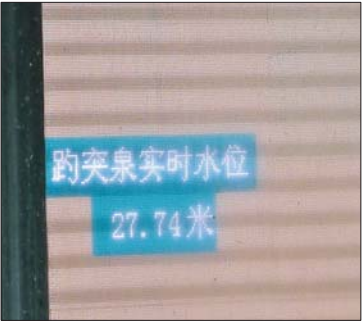
趵突泉水位计发生故障,等待维修。
