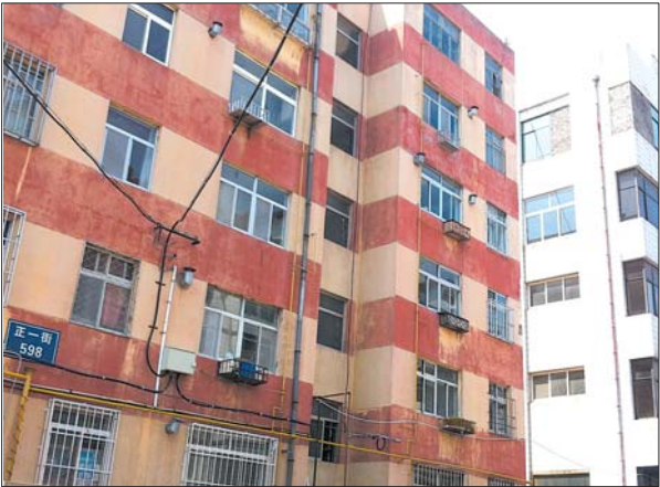
居民楼外的天然气管道成了小偷的“梯子”。本报记者 于飞 摄
