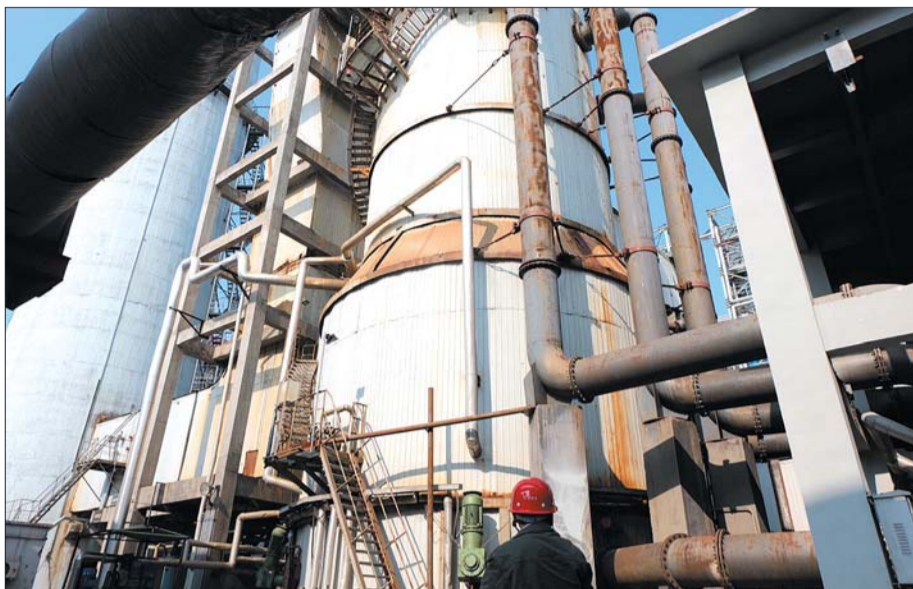
▲北郊热电厂煤粉锅炉的治污设备。
