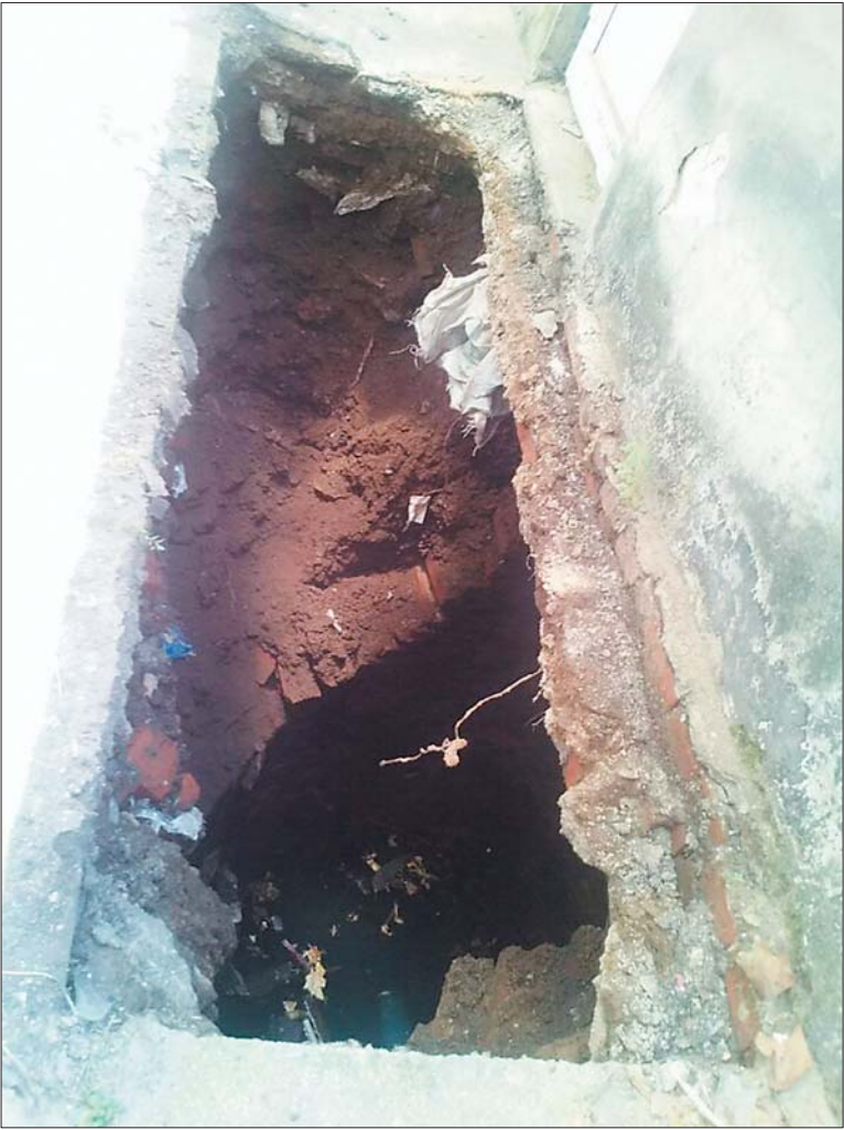
居民楼前塌陷的大坑和坑中的深井。 实习生 王乃正 摄
