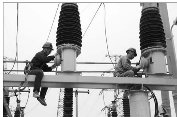
滨州供电公司检修人员对220千伏王木站变电设备进行检修。(代福永 摄)
