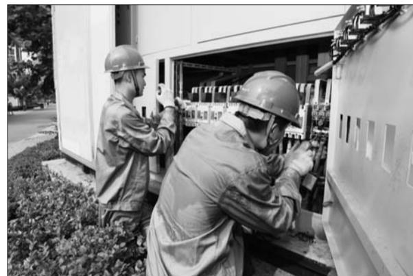
7月29日,滨州供电公司抢修人员对泰山名郡小区7号变压器G5号楼开关进行更换。(代福永 摄)
