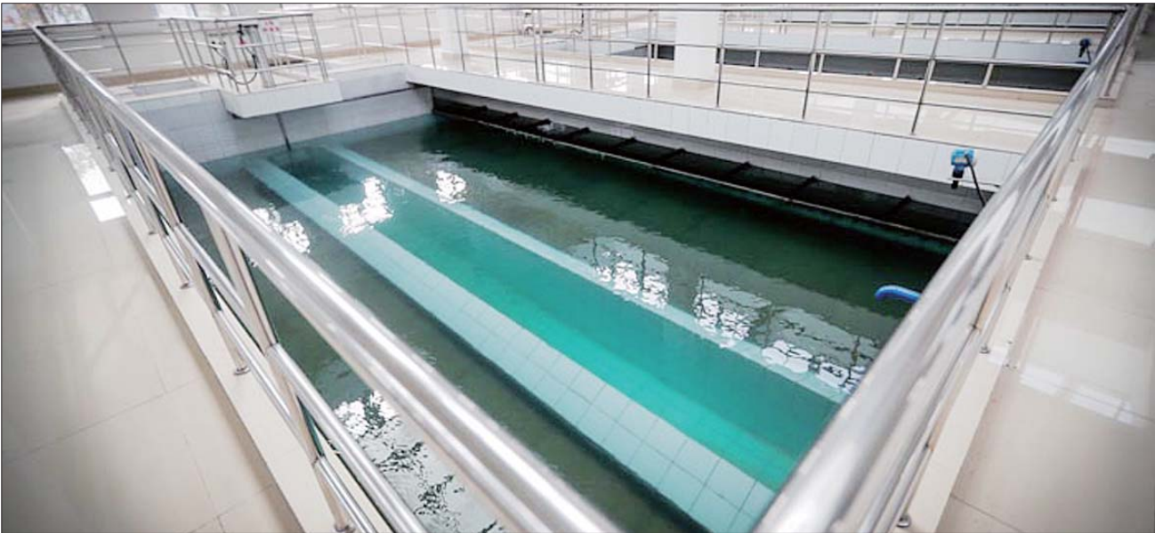
凤凰路水厂有着国内顶尖的设施,为市民提供优质自来水。
