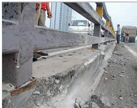
受损的高架桥护栏基座。
