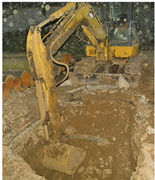
一辆小型挖掘机挖断了煤气管道。姜长龙 摄
