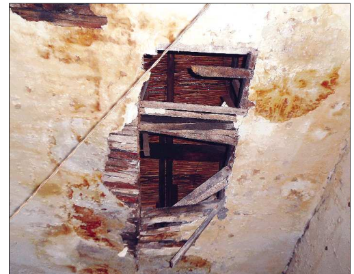
楼顶坍塌处留下的洞。 本报记者 姬生辉 摄
