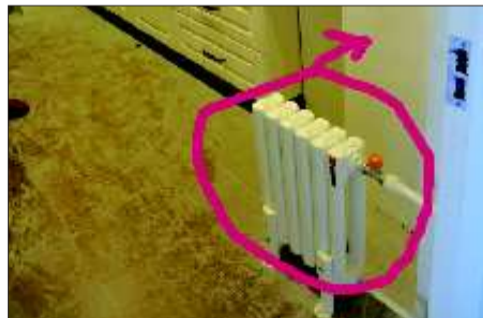
▲一般紧靠墙壁的暖气片,却被如此安装。
