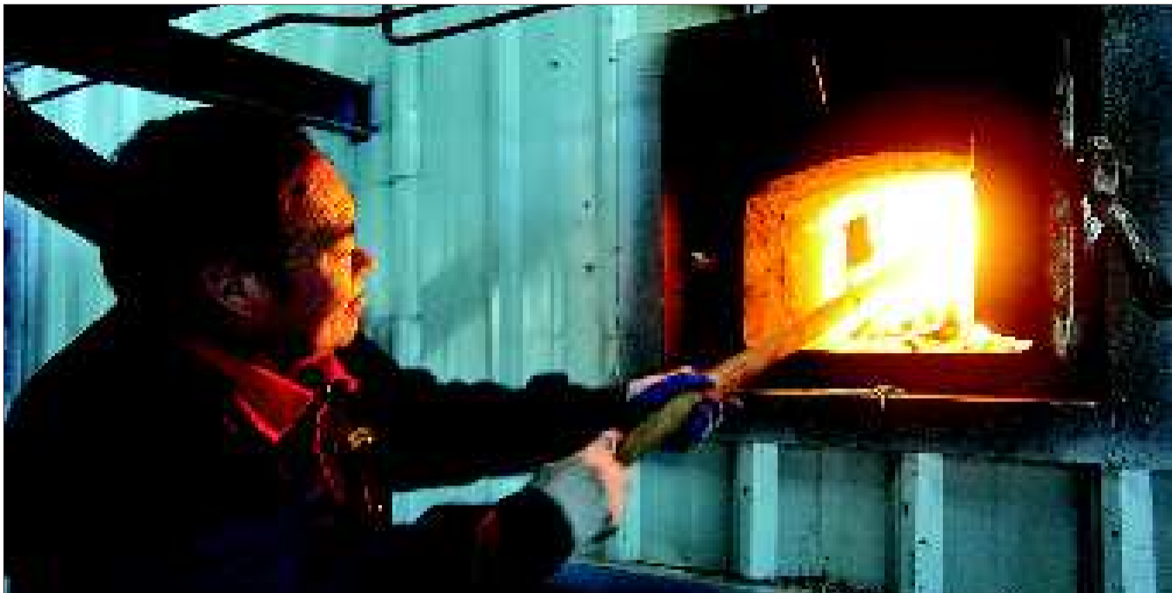
浆水泉热源厂的工作人员在锅炉,随时准备启用供暖。本报记者 徐延春 摄
