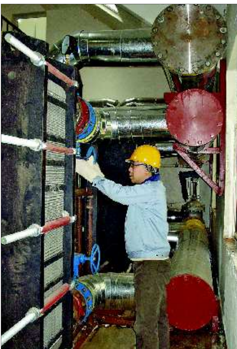
在佛山苑换热站,济南热力的技术人员正对改造后的设备进行调试。 本报记者 王光照 摄
