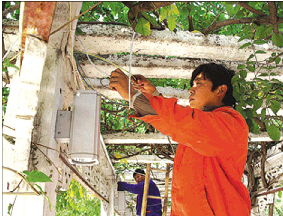
3日,施工人员在岱宗坊游园长廊内安装景观灯线路。本报记者陈琳摄
