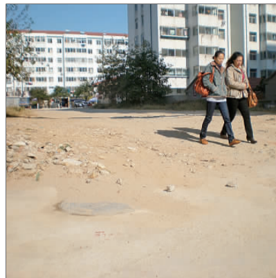
该路段坑坑洼洼,地上满是尘土。
