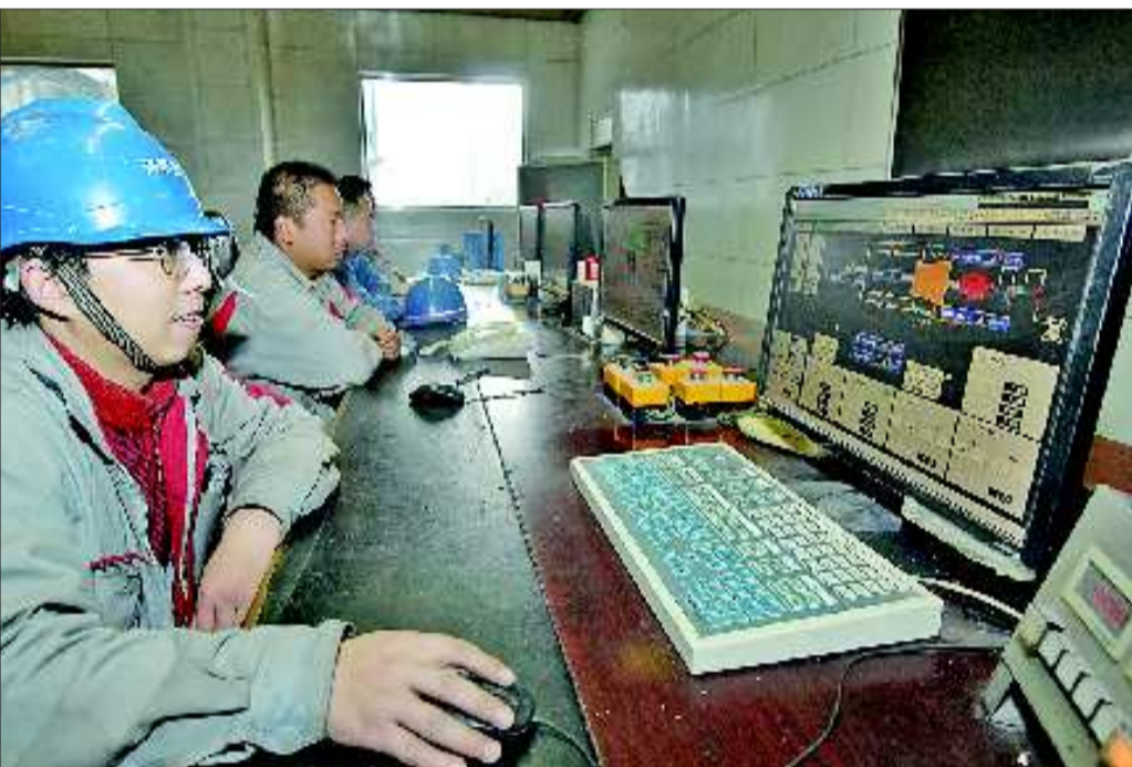
从8日起,省城将开始试供暖。图为在济南北郊热电厂内,工作人员正在对锅炉的运行情况进行监控。
